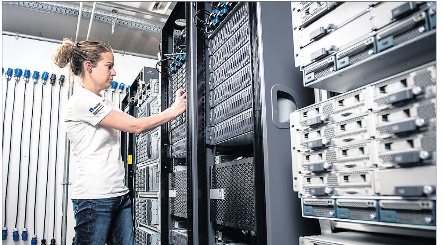
Vor der Auslieferung werden die Systeme aufgebaut und getestet. Hier ein Hochverfügbarkeitsrechner mit 750 TB Kapazität. FIRMENFOTOS
